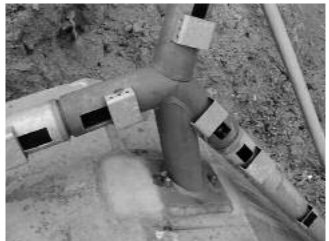
Bild 20. Ansicht eines typischen Lagerpunktes Fig. 20. View of a typical support point
