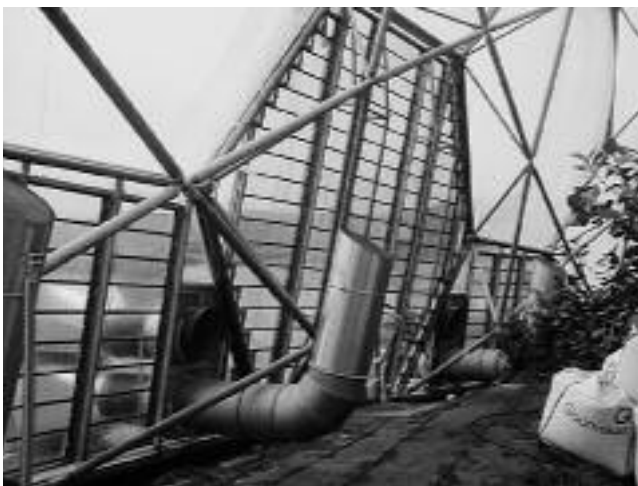
Bild 22. Glaslamellenfelder und Warmluftzufuhr
