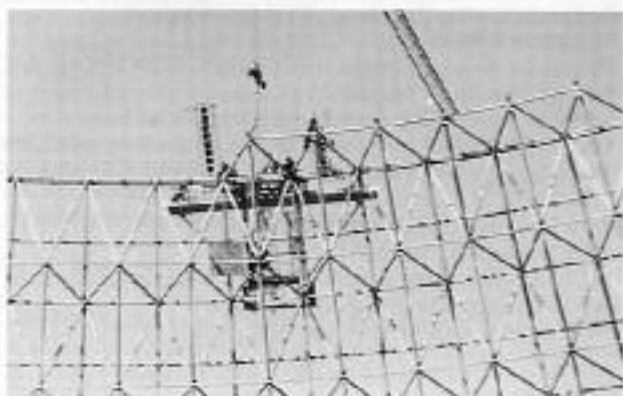
Bild 13. Montage vormontierter Einheiten aus zwei Gurt- und Diagonalmembern und einem Knoten mit einem fahrbaren Hilfsgerüst
