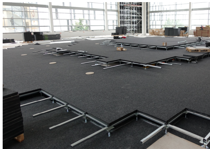
Leitwarte Ebene 2 bis 4
